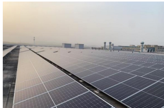
聖都工業園屋頂光伏項目
